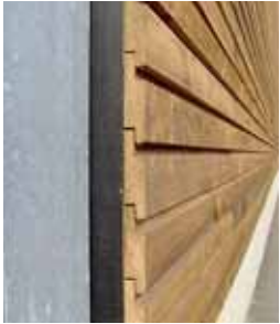
Figur 131: Der Querschnitt einer Fassadenschalung zeigt die hohe Eindringtiefe des Schutzmittels.
